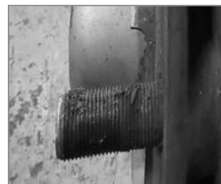
ボルトに著しいさびや汚れの付着
