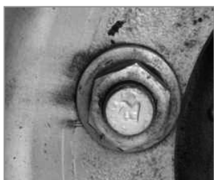
さび汁が流出した痕跡
